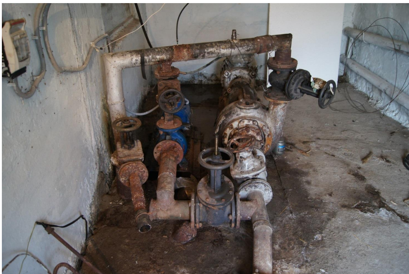
Рисунок 2.4 – Насосная станция второго подъема системы централизованного водоснабжения д. Розенталь
