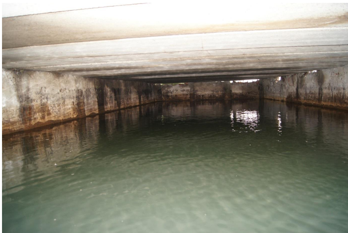
Рисунок 2.3 – Резервуар чистой воды системы централизованного водоснабжения д. Розенталь
